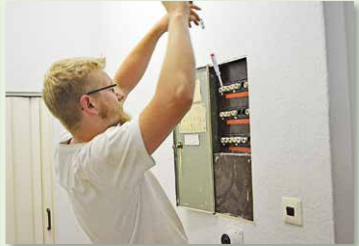
Elektroinstallationen oder -reparaturen sollte man lieber dem Fachmann überlassen, um Verletzungen durch Stromschläge zu vermeiden.
